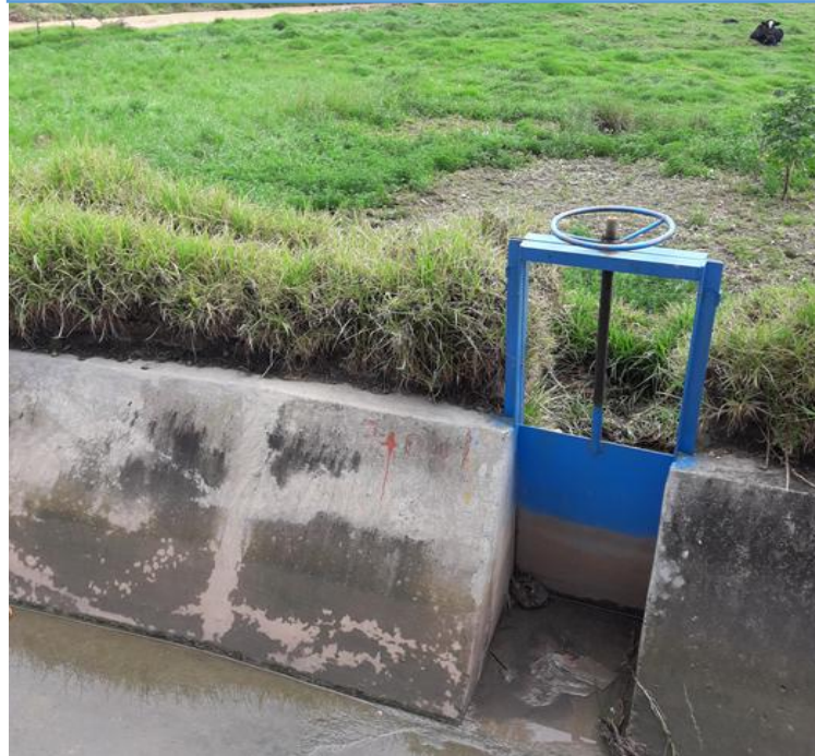
Foto 9. Sistema de compuertas en el canal de regadío, por el cual el agua de riego ingresa a las parcelas.
