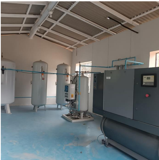
FOTOGRAFÍA 16: Sala de equipo de generación de oxígeno.
