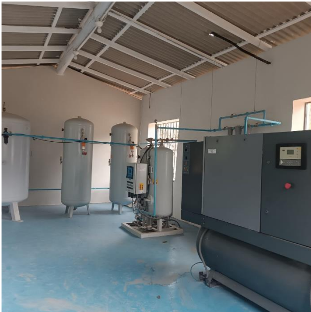
FOTOGRAFÍA 16: Sala de equipo de generación de oxígeno.
