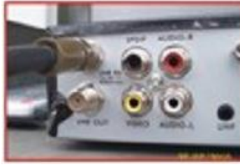
Figura 35: Entrada del Cable RG-6 de la antena Parabólica.
