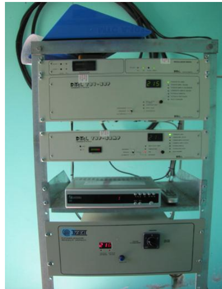
Figura 50: Vista frontal de los equipos.
