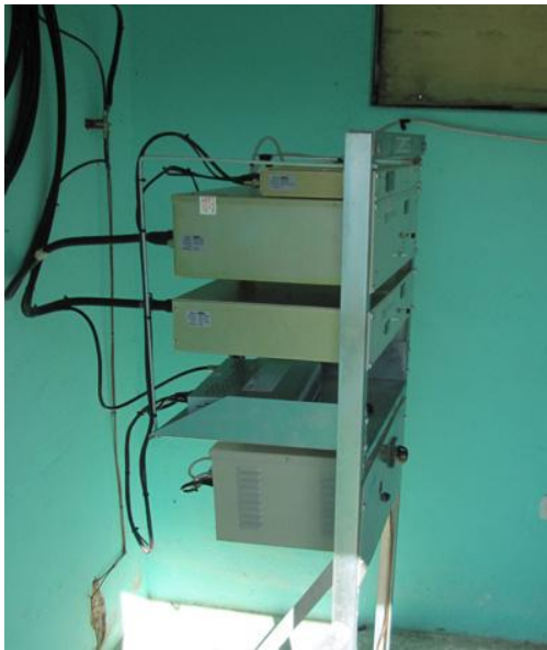
Figura 49: Vista lateral de los equipos en Rack de comunicaciones.
