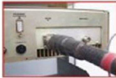
Figura 39: Salida de Cable de RF hacia las antenas de Radio FM.
